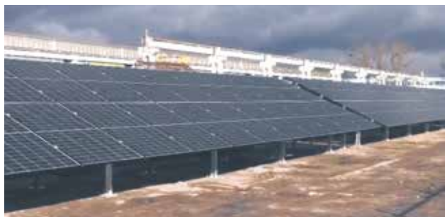
Farma fotowoltaiczna na terenie przy Stacji Uzdatniania Wody Łajski do 50kWp
